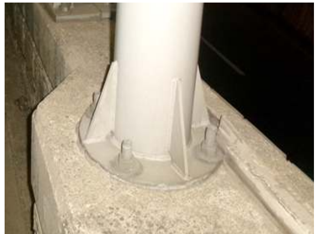
안전 및 기타시설(조명설비(가로등)) 상태현황
