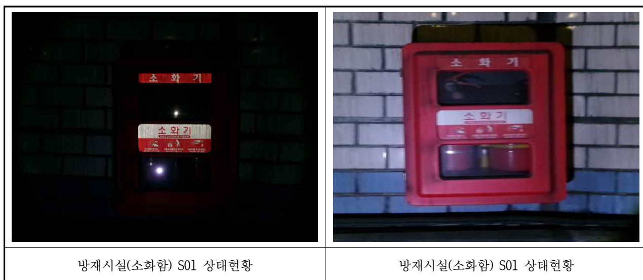
【사진 3.4.17】 방재시설 손상현황
