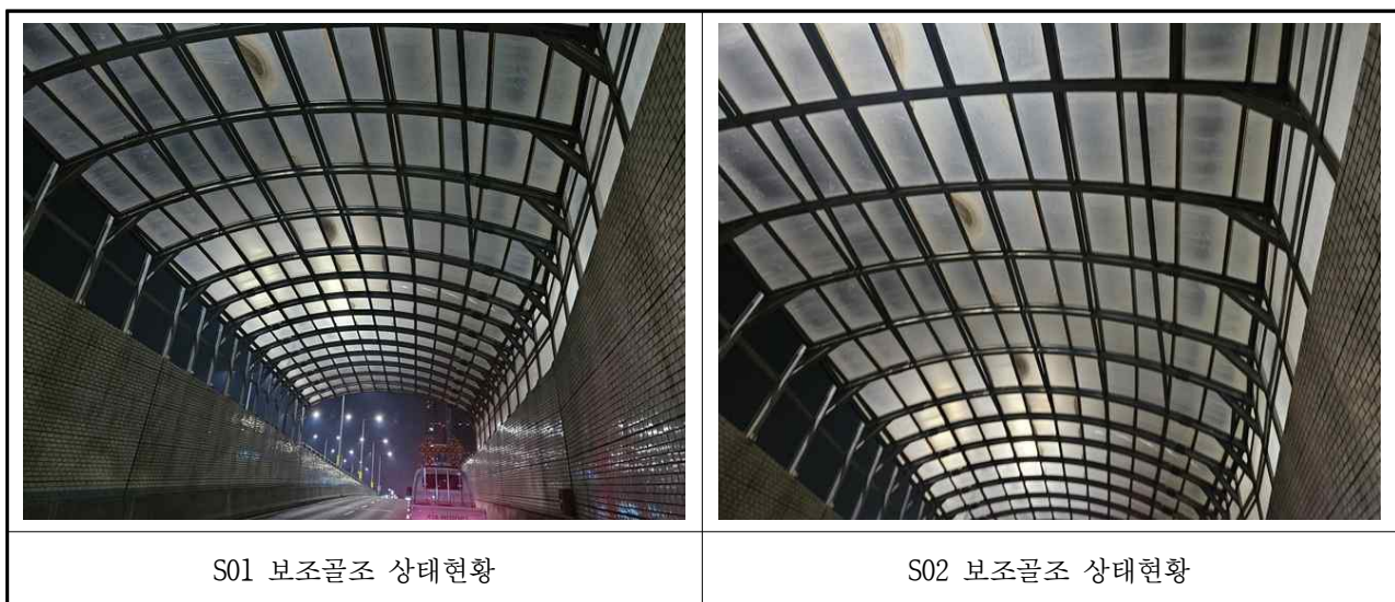
【사진 3.4.4】 보조골조 손상현황
