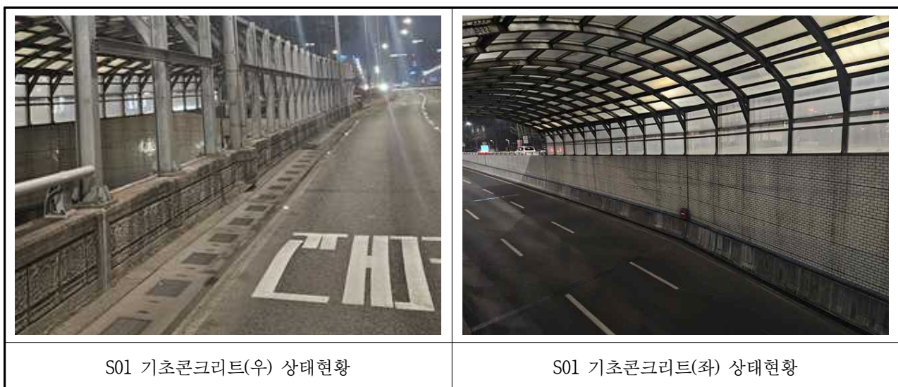
【사진 3.4.8】 기초콘크리트 손상현황
