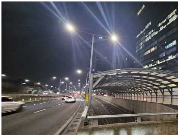
안전 및 기타시설(조명설비(가로등)) 상태현황
