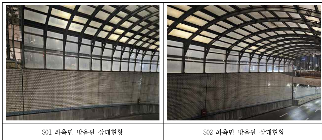
【사진 3.4.10】 방음판 손상현황(계속)
